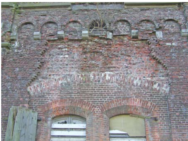
“Schade aan de gevel van het hoofdfrontgebouw (foto Johan De Ridder)>
